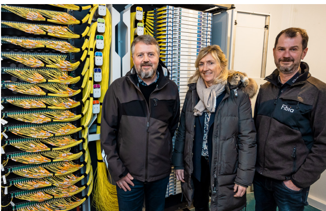
Projektet kom i mål takket være teamworket mellem (fra højre) Frank Hafdell Rhode fra Fibia, Susanne Stengade fra Alcadon ApS og John Porsborg fra CommScope.
