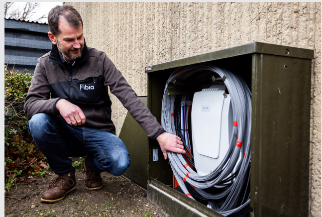
Frank Hafdell Rhode med én af de BUDI™-bokse, der er placeret i gadeskabene nær rækkehusene i Avedøre Stationsby. Herfra fordeles fibrene fra krydsfelternes 96F- og 192F-kabler via 2F-kabler ud til de enkelte lejligheder.
